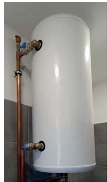
Rézcsővel csatlakoztatott melegvíztartó, hiányzik: tároló földelés és dielektromos közcsavar (plusz tágulási tartály).
