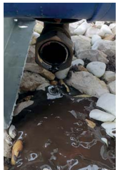
Rozsdaiszap, ez a következménye az elektrokémiai és oxidatív korrózióknak.
