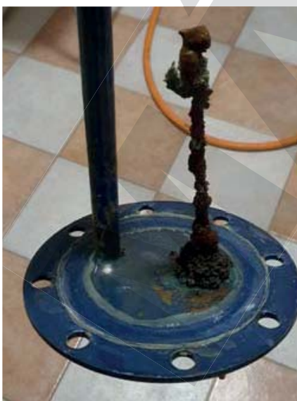
Elektrokémiai korrózió egyik következménye a gyors anódfogyás, ezért indokolt az első anódcseré 12 hónapnál, így annak jelentős fogyása esetén még idejében feltárható a probléma a tároló test sérülése nélkül (azt követően 18 hónap).
