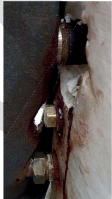
Rézcsővel „kötött” acéltartály csatlakozóinak elektrokémiai korróziója 16 hónap üzemeltetés után, a csatlakozók hegesztési varratainál már első üzeméven belül szivárgást okozhat.
